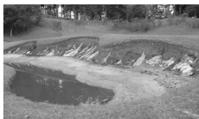
豪雨被害を受けたバンカー
